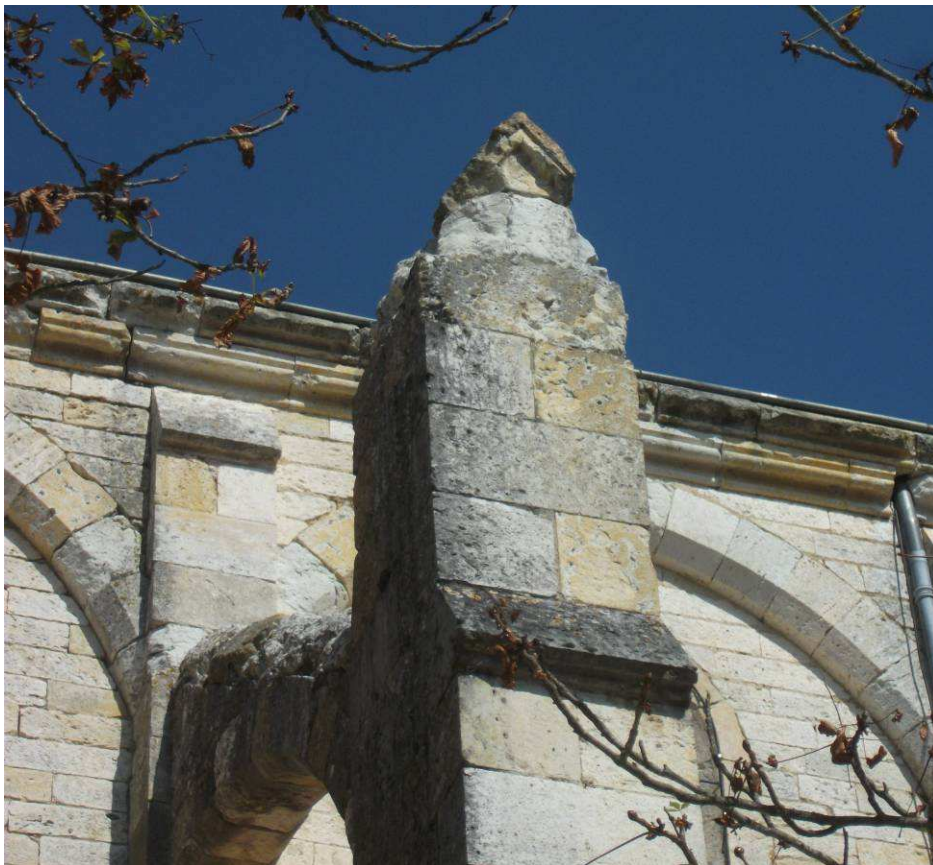
Contrefort, culée et pinacle très altérés
